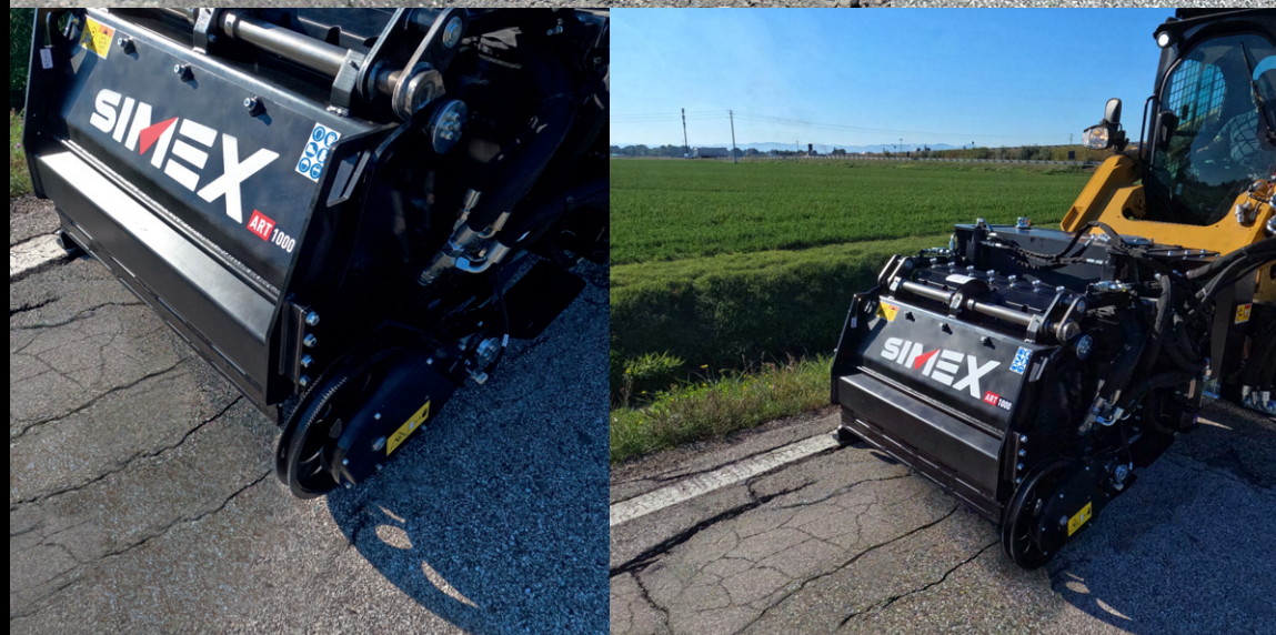
“Pele de crocodilo”, fissuras, deteriorações.
